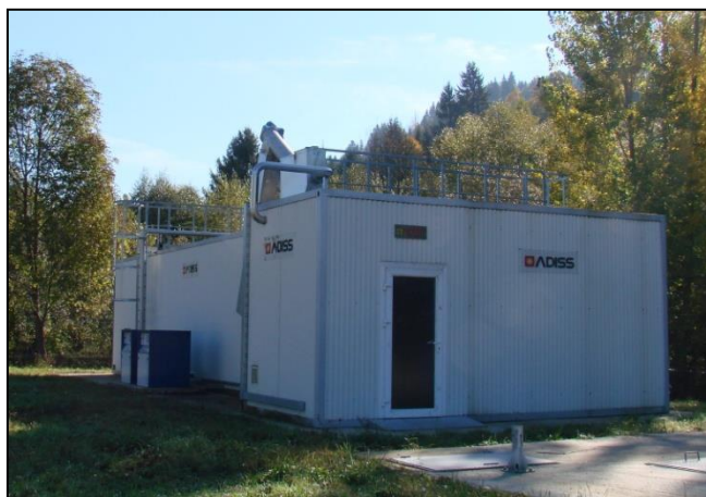
Stația de epurare a apei
